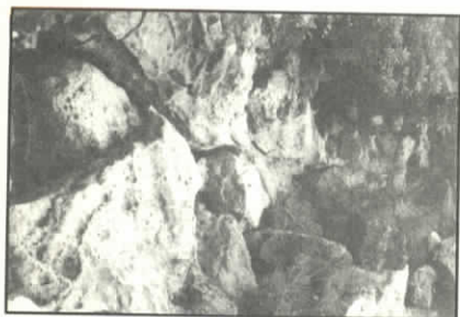
写真8 崩壊寸前の壁部分
